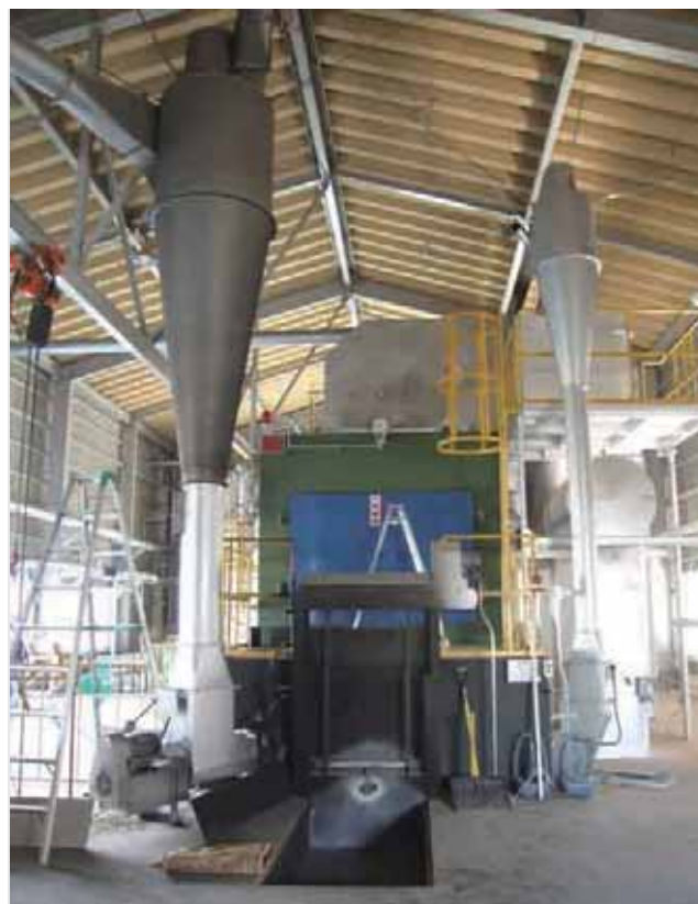
木くず焚きボイラー
