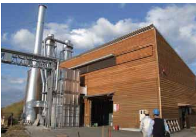
木くず焚きボイラー
