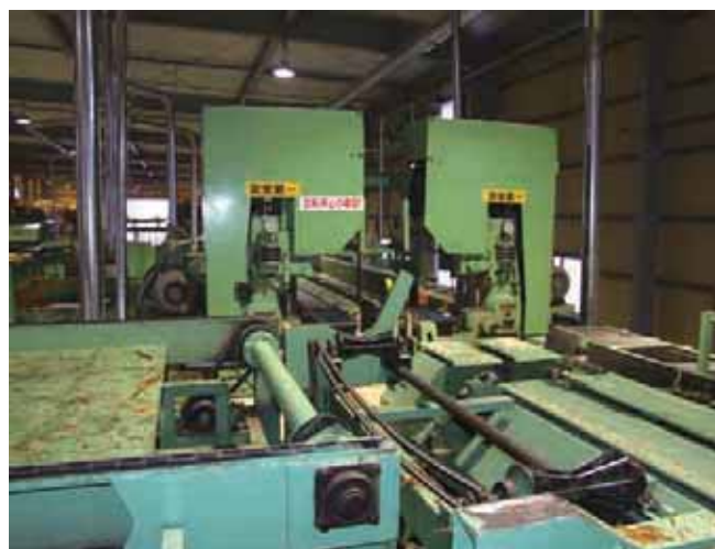
院庄林業で整備した製材ライン
