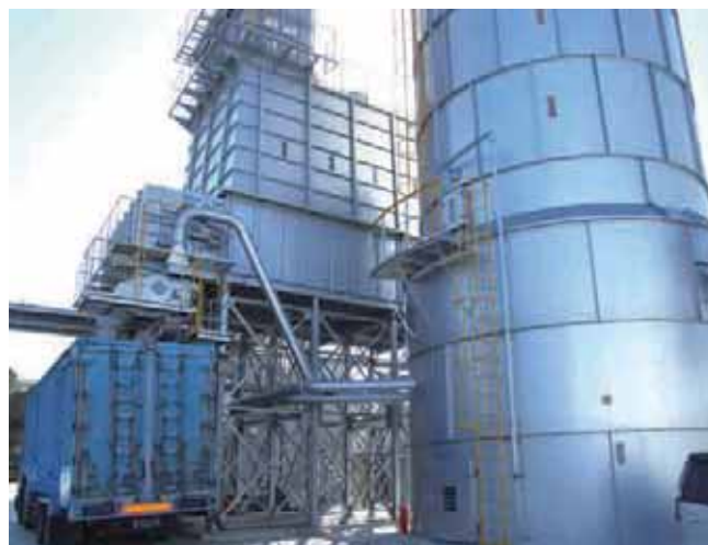
バークや端材を原料とした発電・蒸気発生施設
