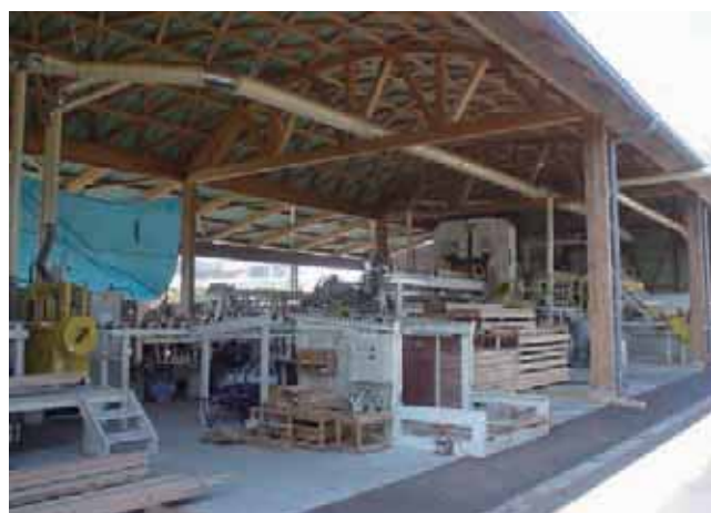
新設した製材ライン
